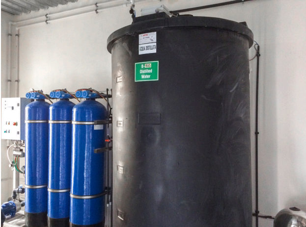
Die neue Abwasseraufbereitungsanlage in Usbekistan garantiert eine Wasserrückgewinnung von 90 bis 95%.
