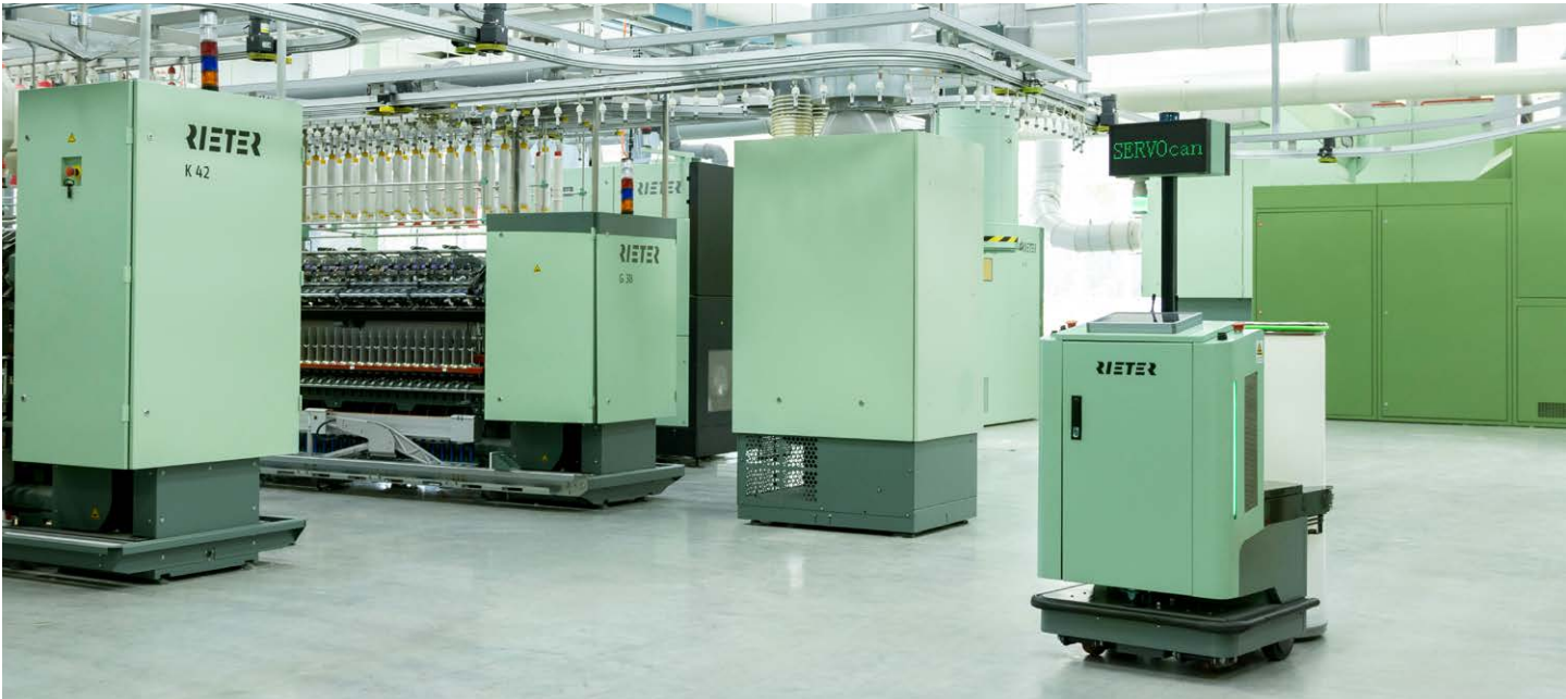
Abb. 2: Der automatische Kannentransport übernimmt eintönige und körperlich belastende Aufgaben.
